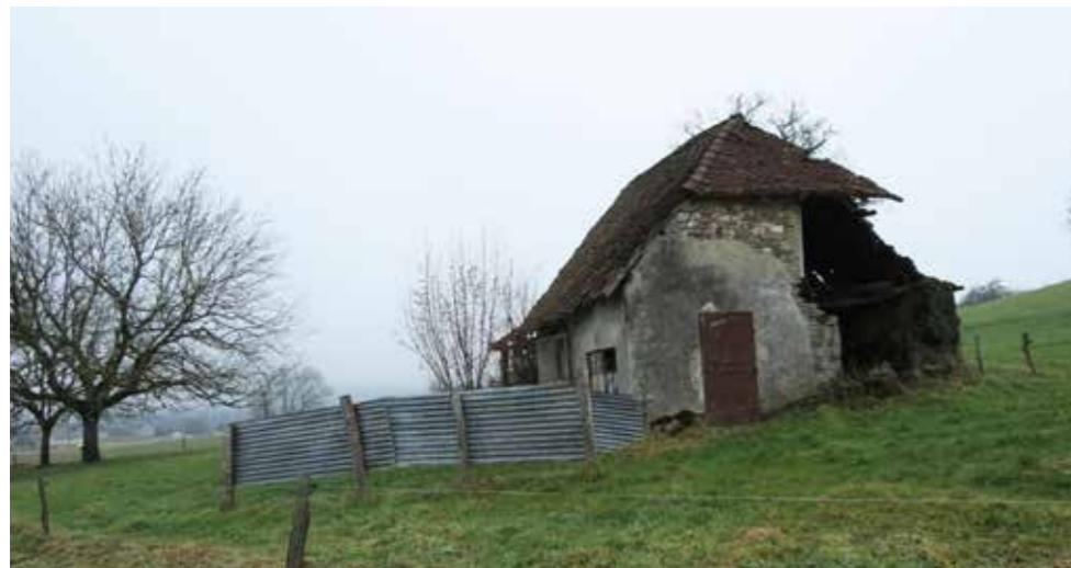
Patrimoine rural en pays de Novalaise: une grange ruinée / Source : DDT 73
